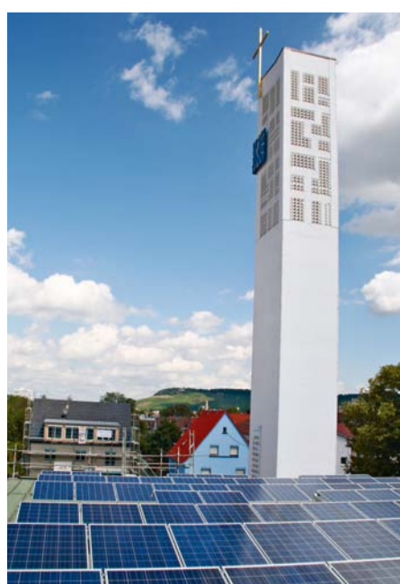
Die Anlage auf dem Dach der Heilbronner Christuskirche ist bereits in Betrieb. Im Hintergrund der Wartberg.
